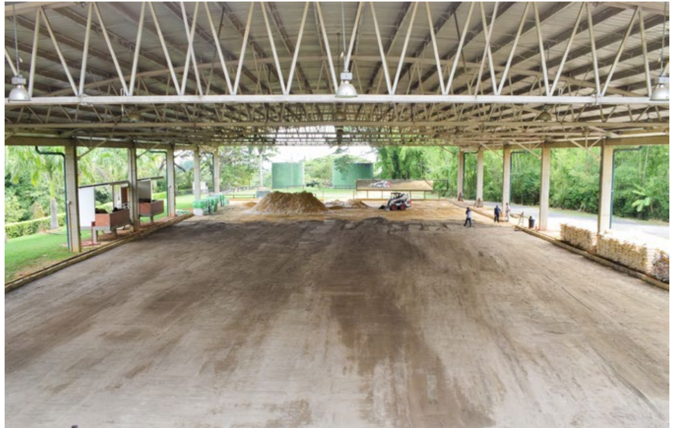
En esta obra se está implementando tecnología alemana para pisos de la firma Otto Sport.
